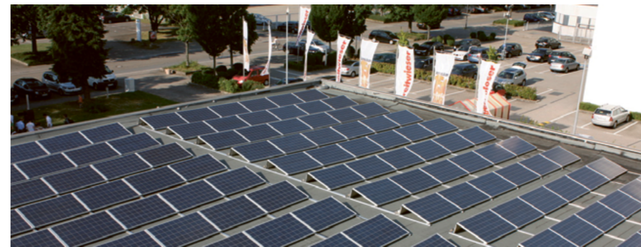
Ein klassisches Geschäftsfeld von Bürgerenergiegenossenschaften: Photovoltaik-Aufdachanlagen.
